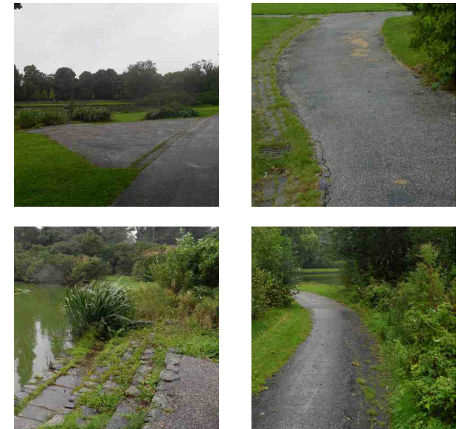
Figuur 6.8: De verharding is op veel plekken in het park beschadigd
